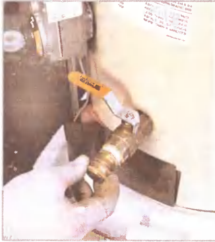
С таким краном можно полностью заполнить бак. В нижней части бака автор заменил стандартный запорный кран на шаровой с резьбой, которая подходит к шлангу. На время монтажа систем на подводный патрубок устанавливают заглушку
