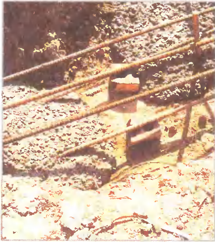
Установка арматурных прутков на обломки битого кирпича перед укладкой бетона — никуда не годная, но, к сожалению, обычная практика
