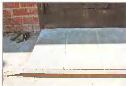
Передний швеллер утоплен в дорожное покрытие и приварен к металлическим штырям, забитым в грунт. Концы швеллера спилены под тупым углом и плавно «уходят» в покрытие дороги
